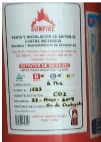
Figura 4-3. Registro de verificación de extintor ya caducado
