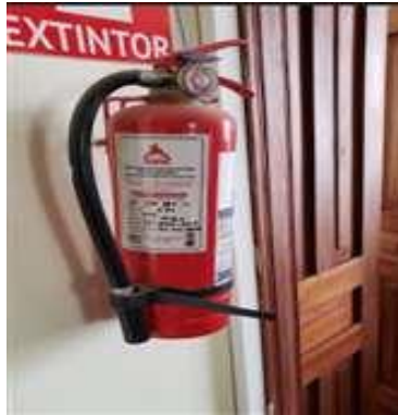
Figura 6-3. Extintores ubicados correctamente - Piso 1
