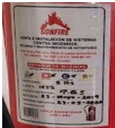
Figura 7-3. extintor con su respectivo registro ya caducado
