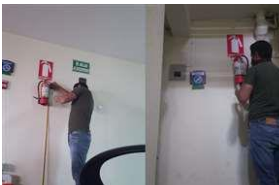
Figura 1-4: Implementación de extintores
