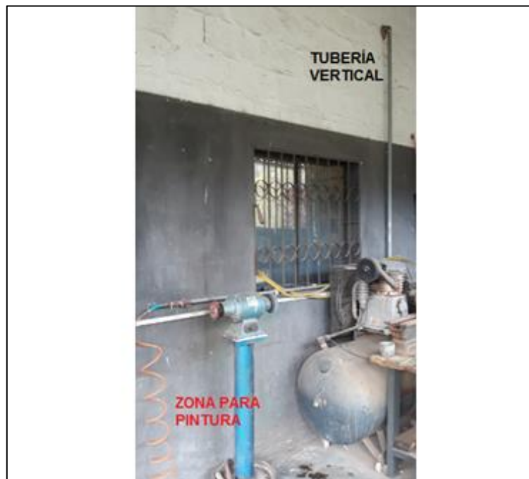
Figura 3-3: Tubería vertical de diámetro 1 ¼”
