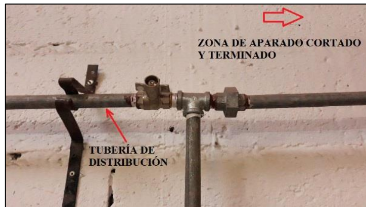
Figura 5-3: Tubería de distribución con diámetro de ½”, con dirección a la siguiente zona
