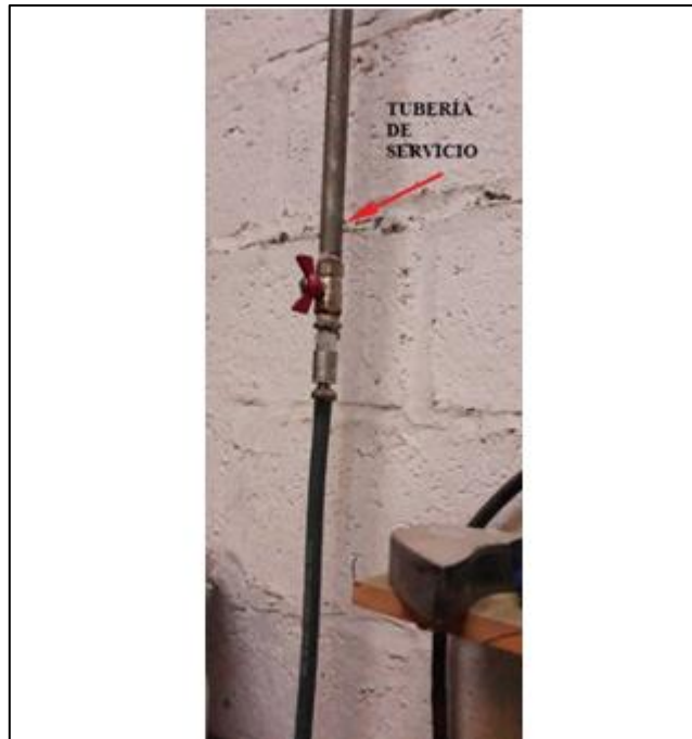
Figura 6-3: Tubería de servicio de diámetro de \frac{1}{2} ".
