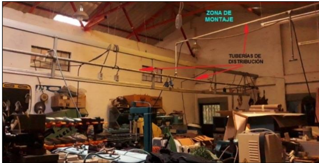
Figura 4-3: Tuberías de distribución en 1 ¼” de diámetro.
