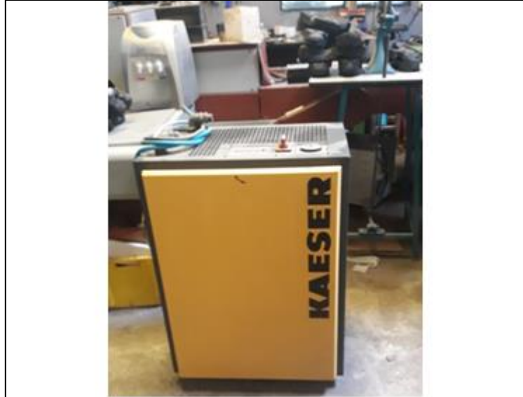
Figura 8-3: Secador de aire comprimido de la fábrica, sin instalación.
