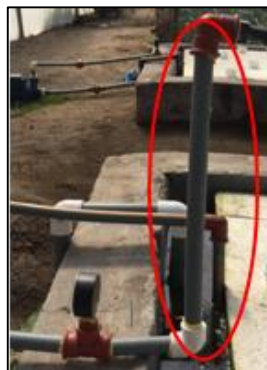
Figura 17-3. Tubería de descarga del sistema por gravedad
