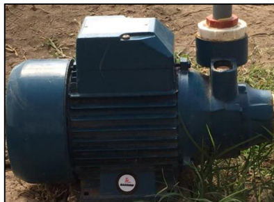
Figura 7-3. Bomba Centrífuga del sistema por recirculación
