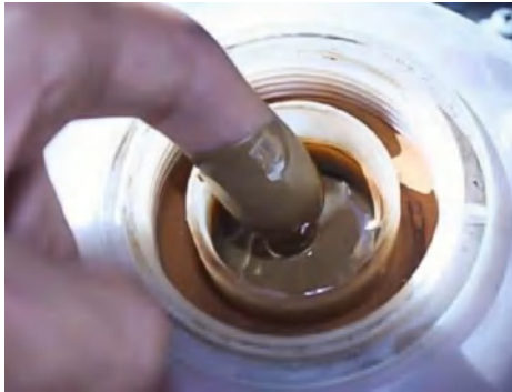
Figura 34-1. Presencia de aceite en depósito del refrigerante
