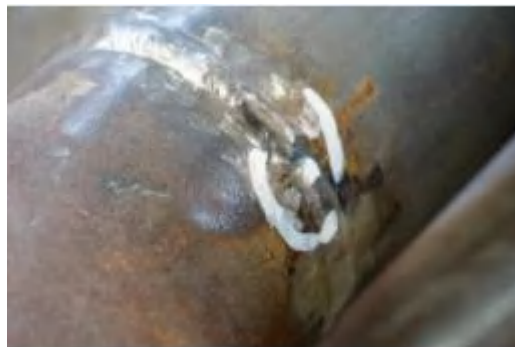
Figura 27-1. Defecto en el proceso de soldadura
