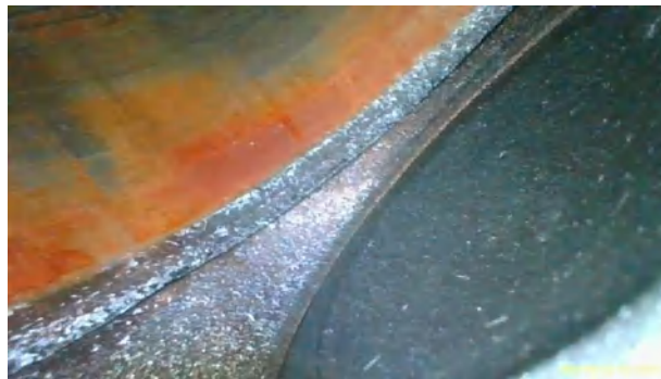
Figura 30-1. Corrosión generada en las paredes del cilindro
