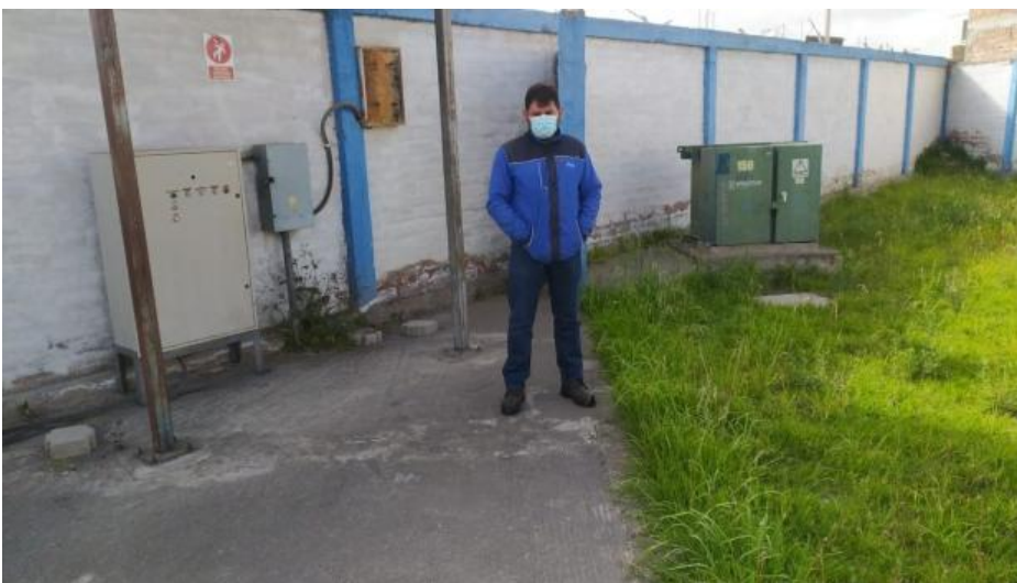
Fotos 27 y 28: Pozo Servidores.
