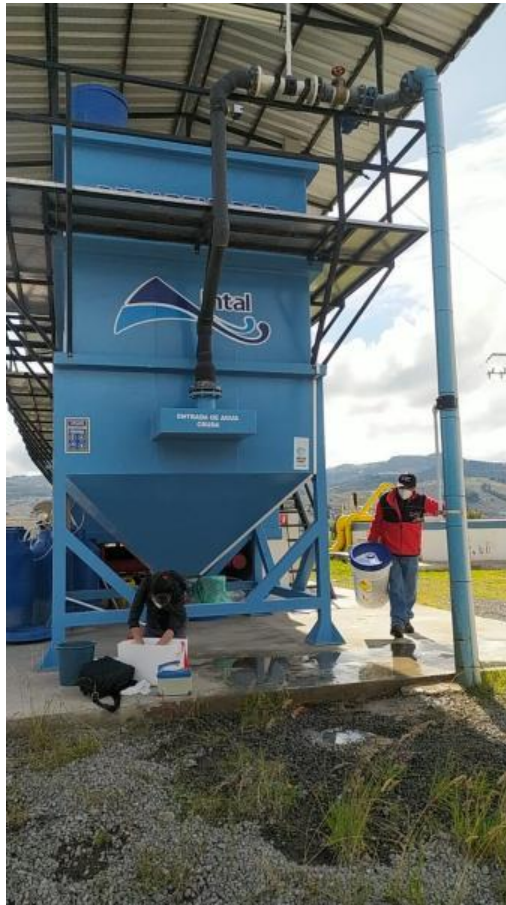
Foto 17: Planta de tratamiento de San Juan Alto de Chacaza Matipanga.
