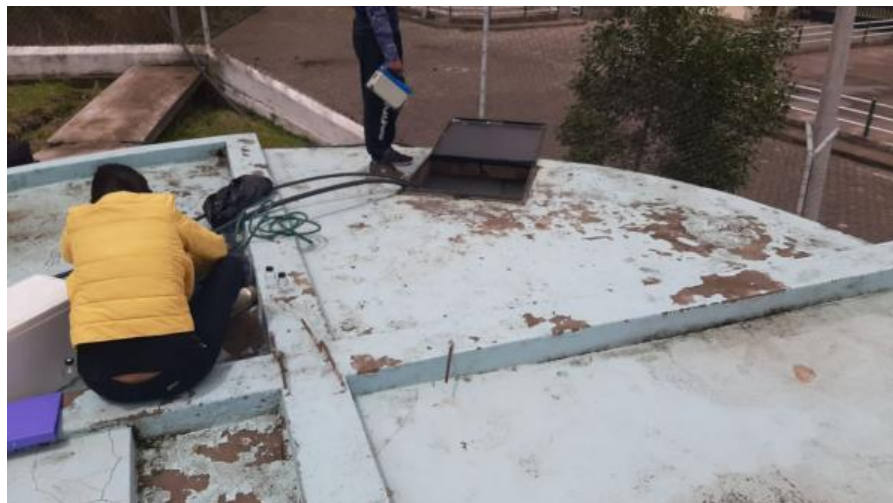
Foto 10 y 11: Tanque reservorio Plaza de Rastros.
