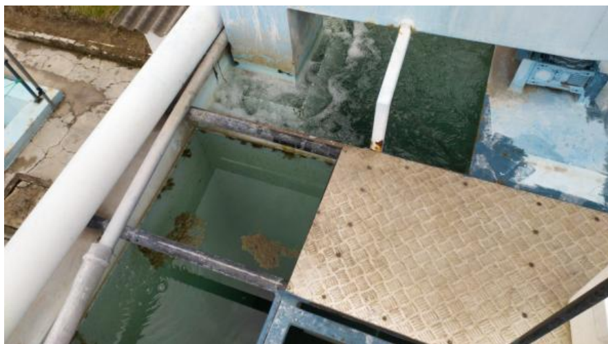
Foto 6, 7 y 8: Piscinas de captación de agua, provenientes del tanque de reservorio Tixán.
