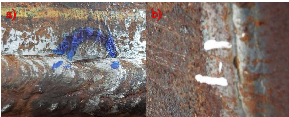
Figura 22-2: Socavación a) externa b) interna.
