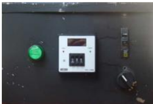
Caja de control
