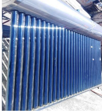
Figura 3-B: 30 tubos al vacío son instalados para este equipo hacia el tanque térmico.
