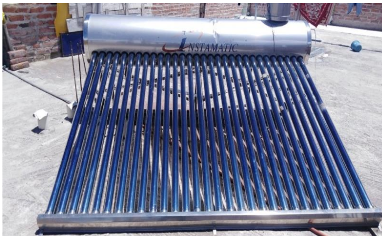
Figura 1-3: Colector solar de tubos al vacío instalado de 300 litros en Riobamba. Fuente: José Salao Bravo, 2019.
