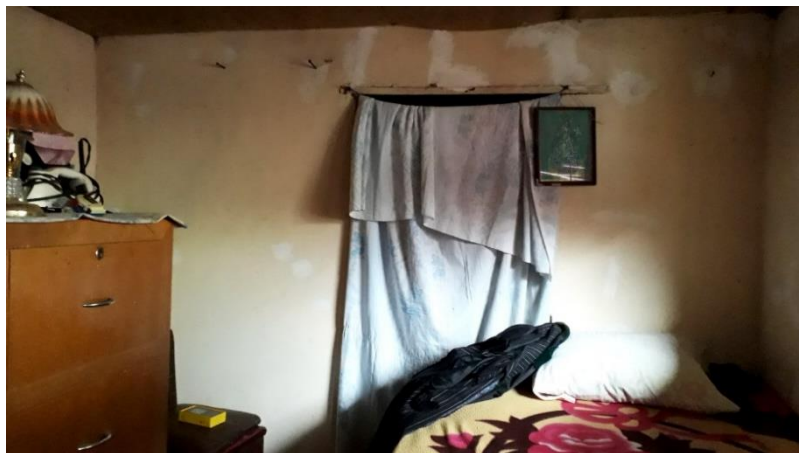
G.1 Toma de concentración en vivienda antigua.
