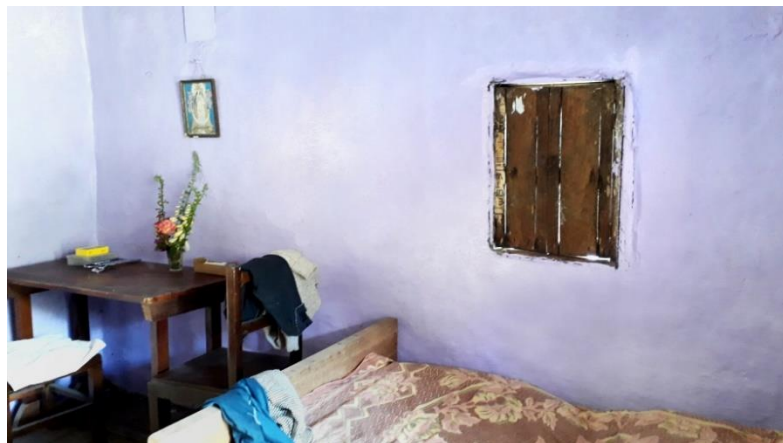
I.1 Toma de concentración en vivienda antigua.
