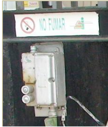
Figura 3.41 Señal adhesiva deteriorada
