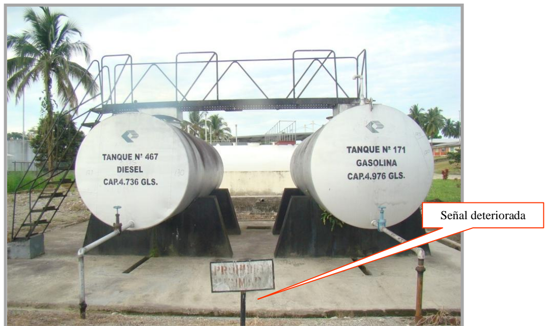
Figura 2.6 Señal en mal estado
