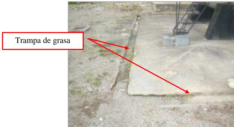
Figura 2.11 Trampa de grasa en tanques de combustible en mal estado.
