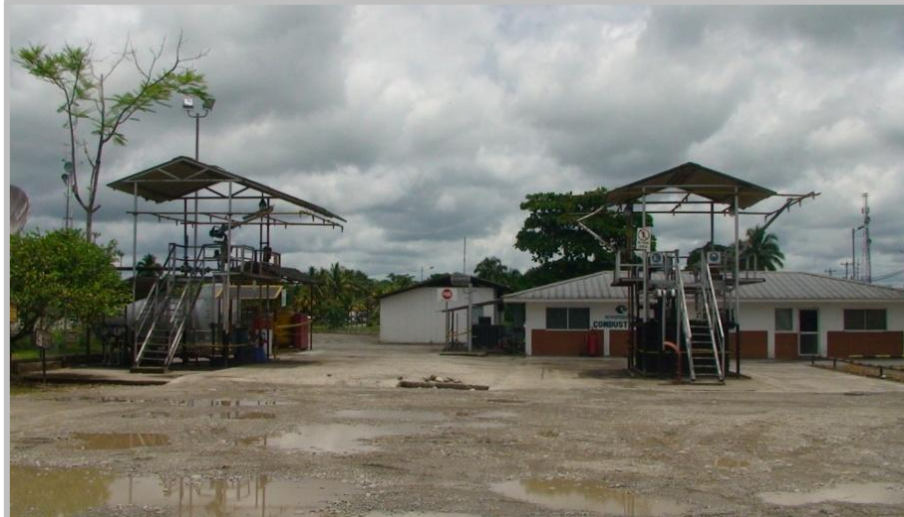
Figura 2.8 Islas de carga (Diesel y Gasolina)
