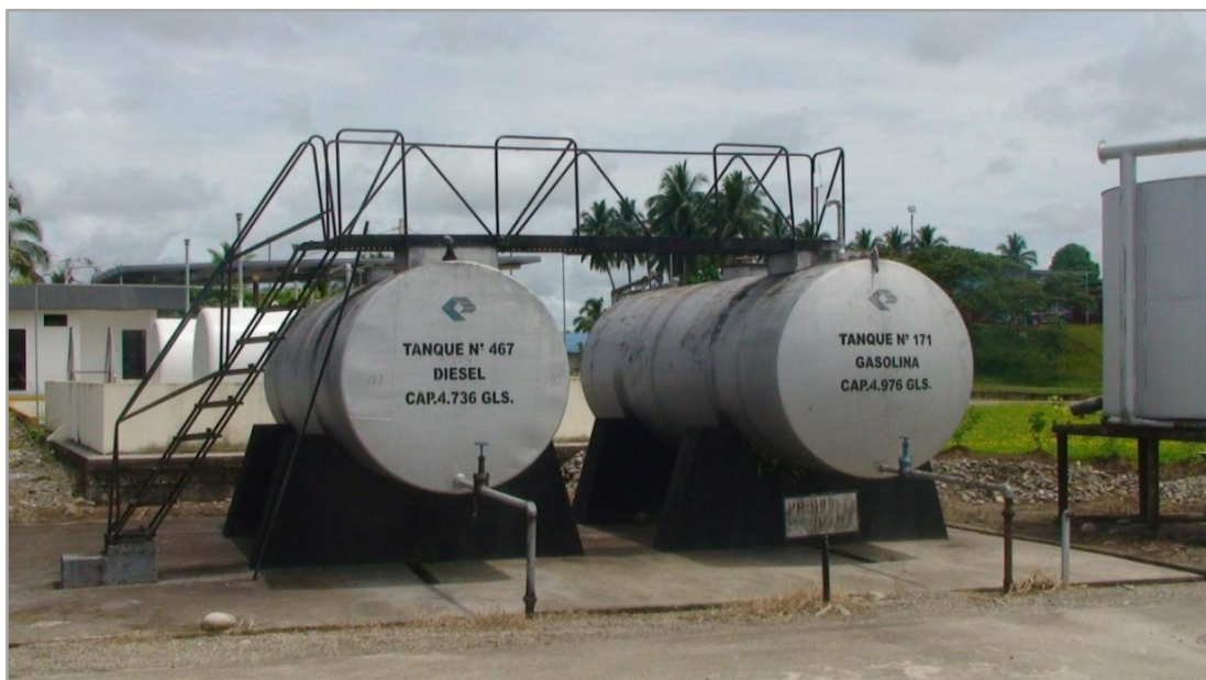
Figura 2.12 No existe la retención (cubeto) en la zona de almacenamiento
