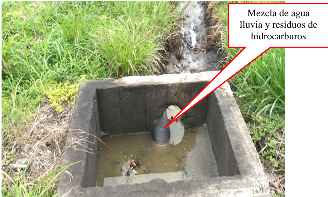
Figura 2.14 Caja recolectora de residuos líquidos en mal estado.
