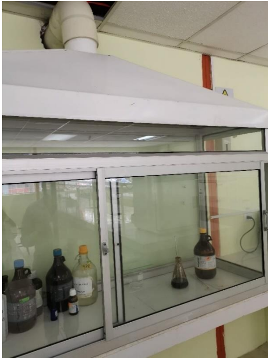
Figura 6C. Campana de extracción de gases.
