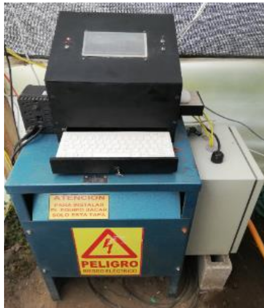
Figura 24-3. Equipo de control eléctrico y electrónico
