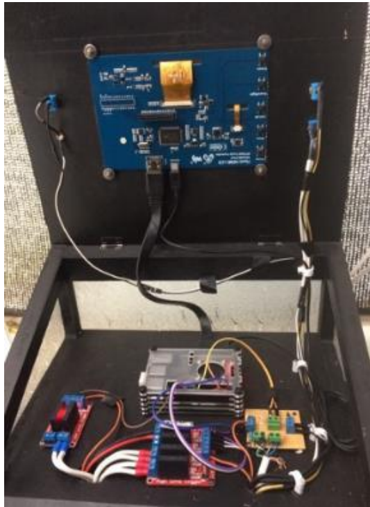
Figura 9-3. Tablero de control
