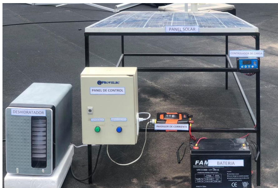
Figura 28-5 Vista General del Deshidratador
