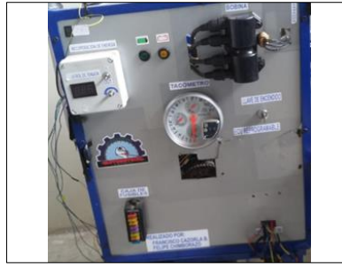
Figura 8-2: Tablero electrónico de control
