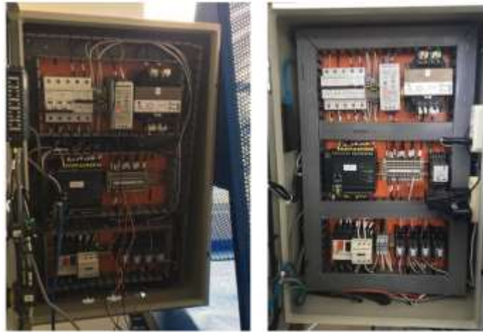
Figura 44-3. Caja de control del LRV terminada.
