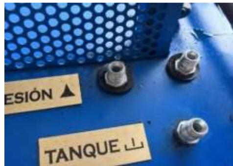
Figura 4-3. Acoples rápidos incompletos con empaques en mal estado.
