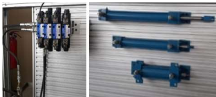
Figura 3-2. Cilindros doble efectos y electroválvulas ubicados en otro panel de trabajo.
