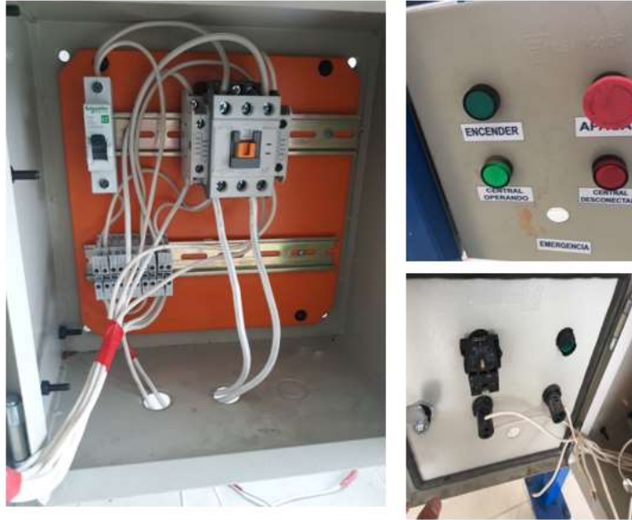
Figura 3-1. Caja de control eléctrico del banco Oleohidráulico.
