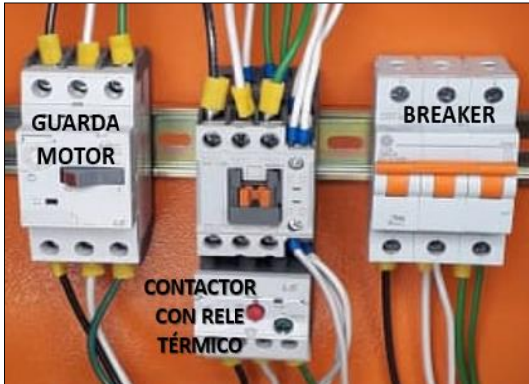
Figura 9-3. Parte interna del gabinete modular
