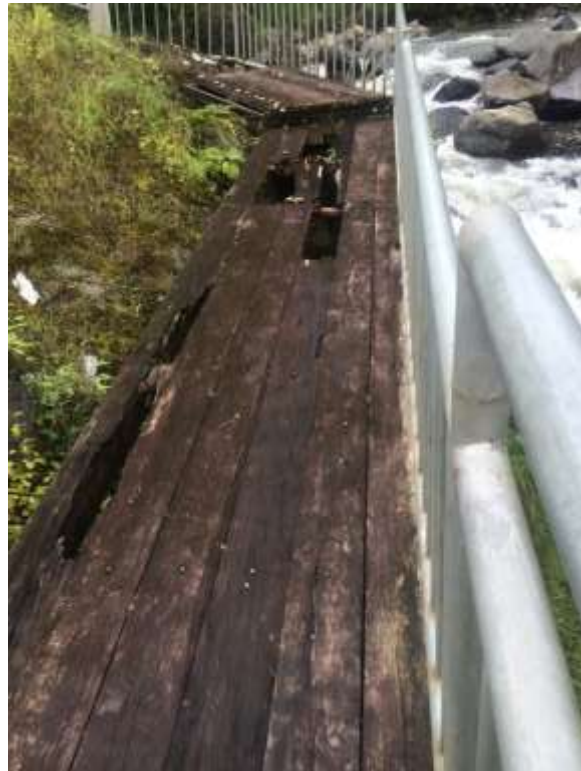
Anexo F: Senderos en pésimas condiciones
