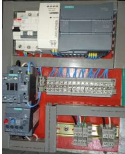
Figura 45-3: Dispositivos de elementos del tablero
