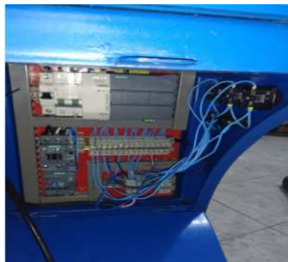
Figura: 46-3: Cableado del circuito de control y fuerza
