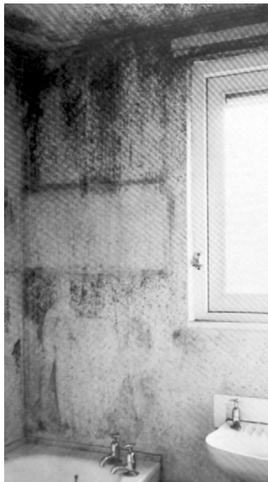
Figura 13 Presencia de moho.
