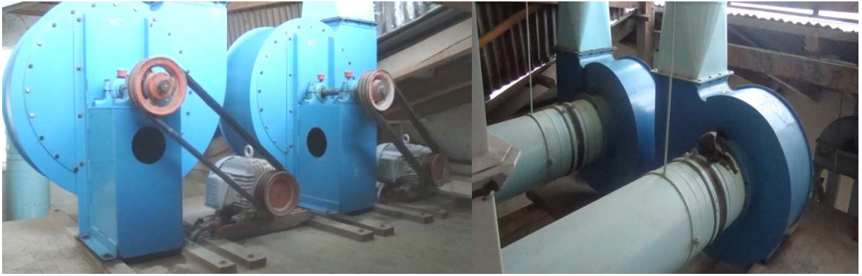
Figura 4.3: Ventiladores Centrífugos de Limpieza 1 y 2
