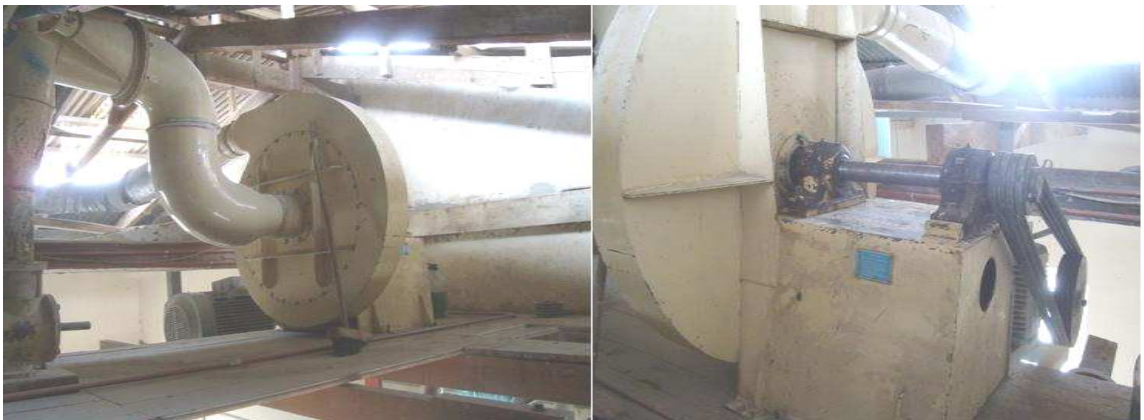
Figura 4.6: Ventilador del Sistema de aspiración de harina
