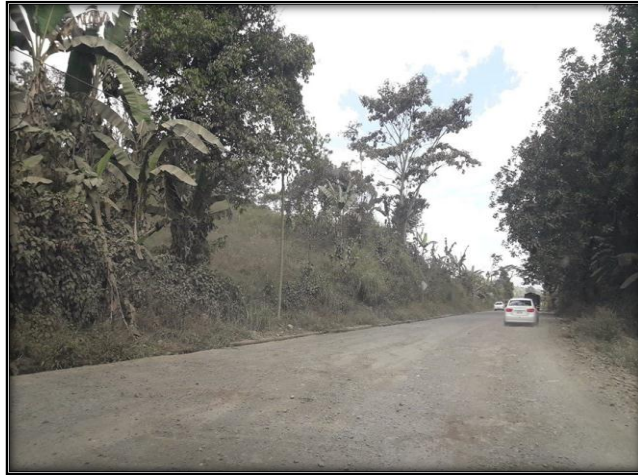
Ilustración 6: Desgaste de Carpeta Asfáltica.
