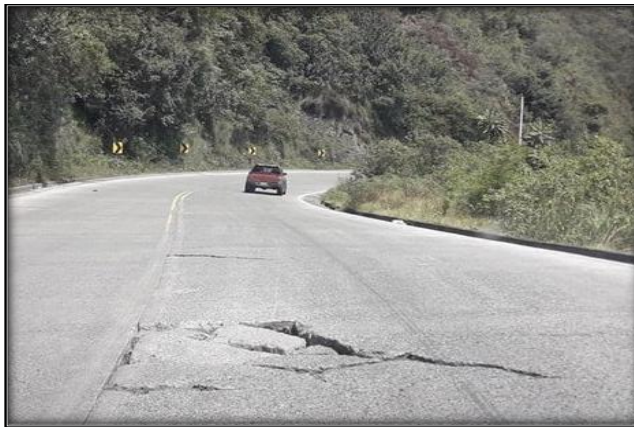
Ilustración 5: Hundimiento de Carpeta Asfáltica
