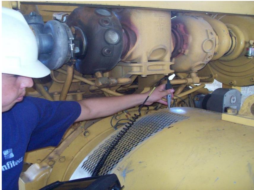
Figura 4.68: Generador Lado Acople P3V (Grupo Electrónico EGEELE0102)
