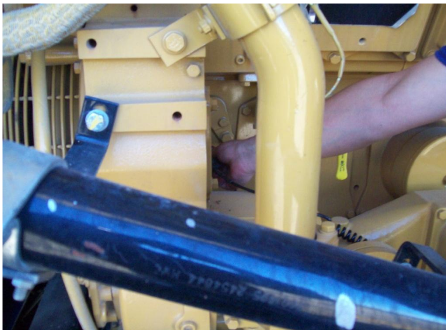
Figura 4.73: Motor Lado Ventilador P1H (Grupo Electrónico EGEELE0255)
