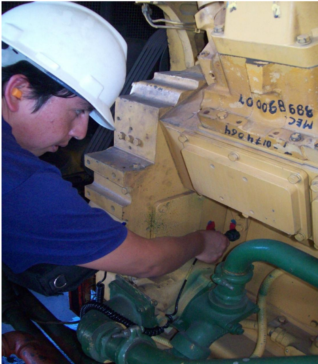
Figura 4.61: Motor Lado Ventilador P1H (Grupo Electrónico EGEELE0102)
