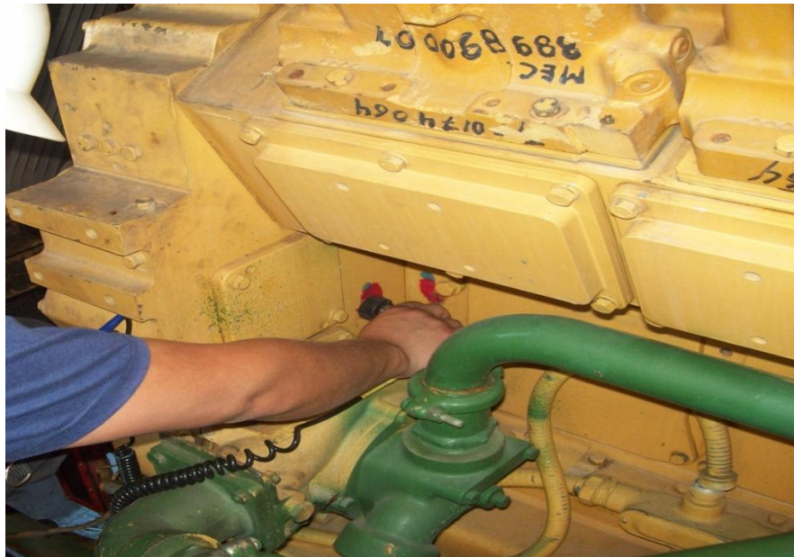
Figura 4.63: Motor Lado Ventilador P1A (Grupo Electrónico EGEELE0102)
