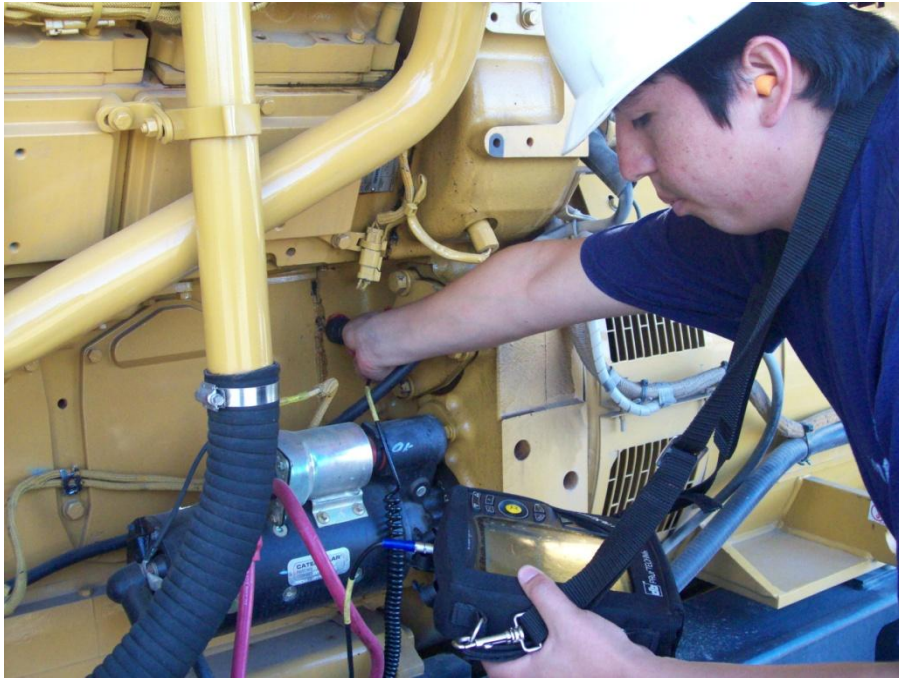
Figura 4.76: Motor Lado Generador P2H (Grupo Electrónico EGEELE0255)
