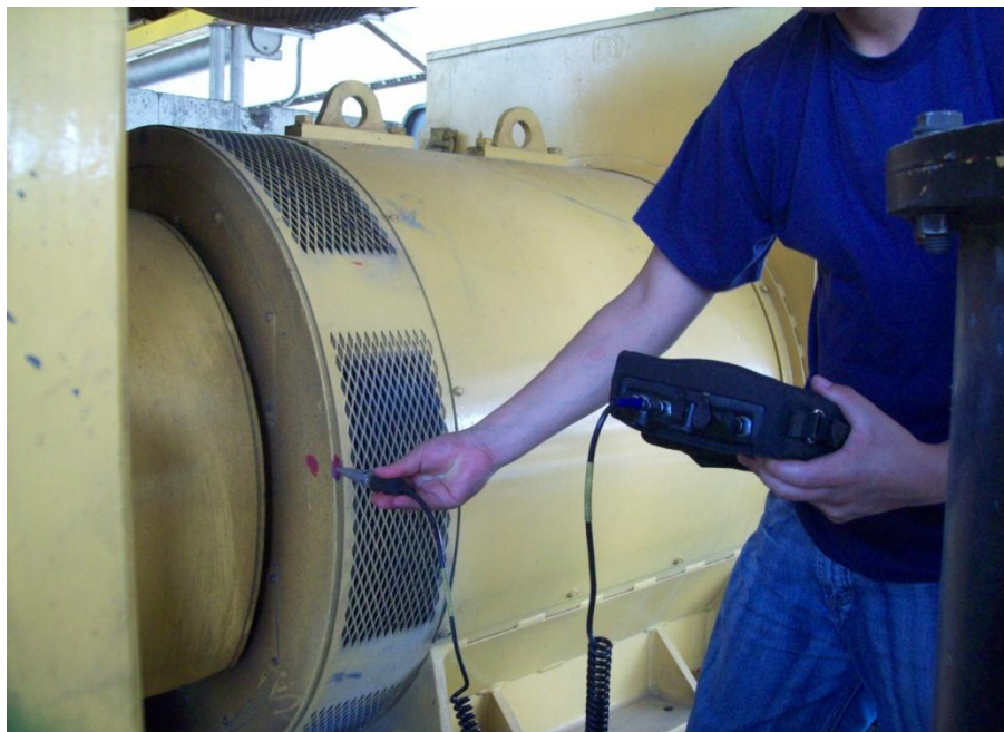
Figura 4.67: Generador Lado Acople P3H (Grupo Electrónico EGEELE0102)
