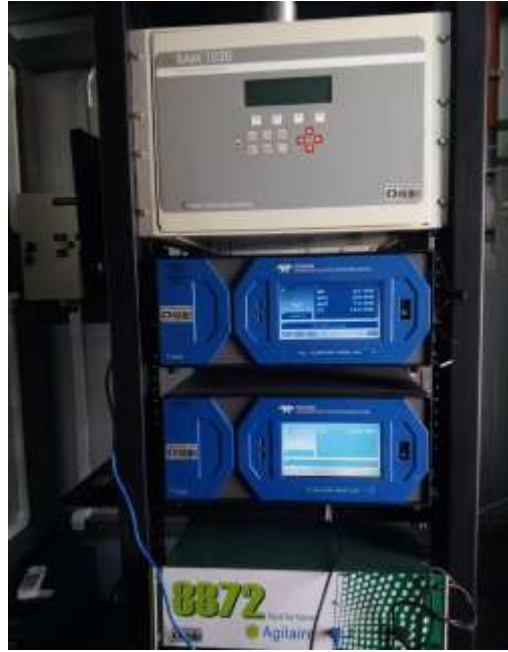
Figura 14-3: Equipos de la Estación de Monitoreo Automático del Aire.
