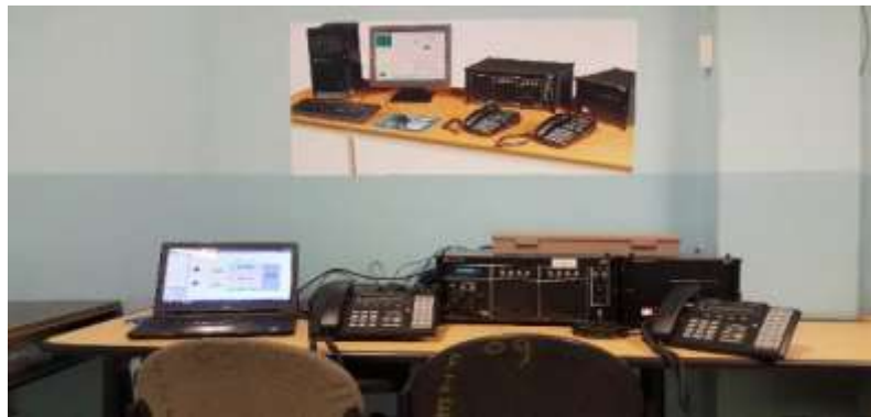
Figura 60-2. Montaje e instalación del sistema didáctico de telefonía. Realizado por: (Denny Posligua, 2018)
