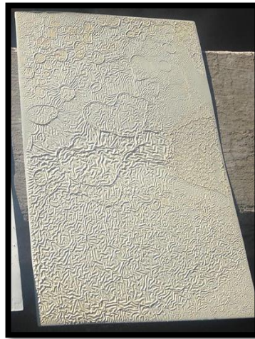
Fotografía 23-3. Resultado de herrumbramiento de la placa blanca Realizado por: Daniela Cabezas, Enrique Mejía, 2018
