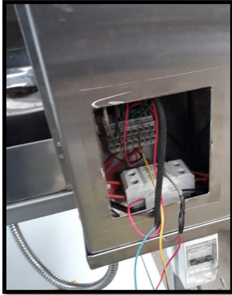
Fotografía 9-3- Relé dentro del panel de control Realizado por: Daniela Cabezas, Enrique Mejía, 2018
