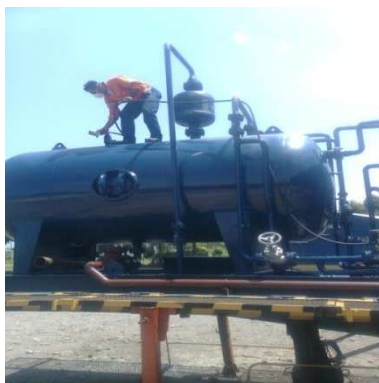
Figura 67. Trabajos en altura sin protección.
