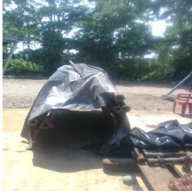
Figura 65. Inadecuado almacenamiento de materiales.
