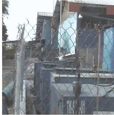
Figura 63. Tanques de combustible al aire libre.
