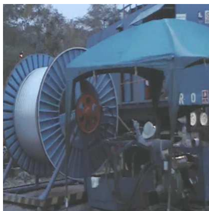
Figura 72. Falta de equipos de protección para trabajos en el campo.
