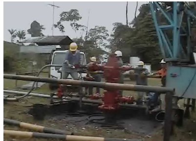
Figura 14. Operación de válvulas.
